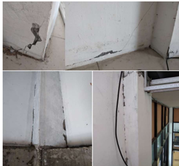
Gambar 2. Foto kerusakan struktur gedung Dinas Pendidikan dan Kebudayaan Kota Palu pasca gempa
