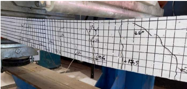
Gambar 10. Pola retak balok beton bertulang sampel 1
