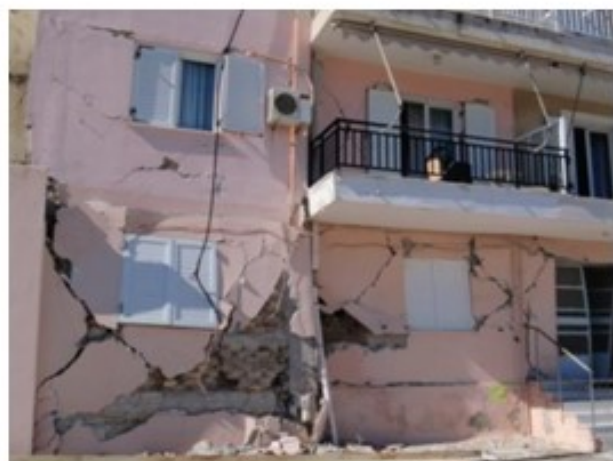
Gambar 1. Kerusakan pasangan bata bangunan gedung bertingkat [10].
