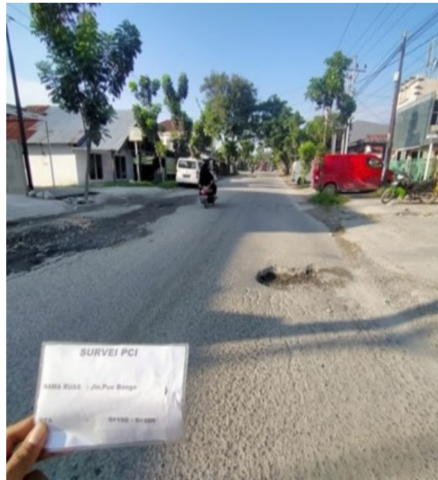
Gambar 5. Kerusakan Retak Blok, Pelepasan Butiran, Lubang, Retak melintang
