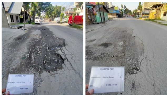
Gambar 3. Kerusakan lubang, retak kulit buaya, pelepasan butiran
