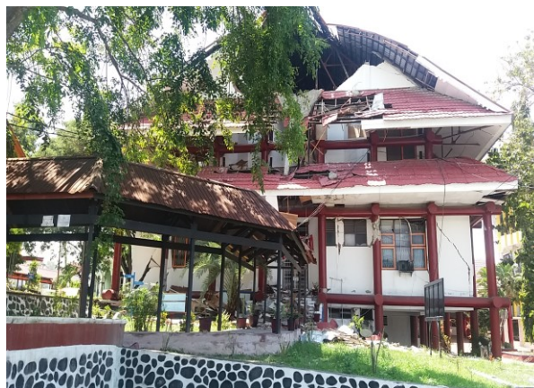
Gambar 4. Kerusakan pada struktur kap
