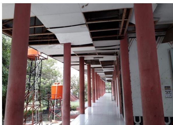
Gambar 5. Kerusakan plafond bangunan sederhana
