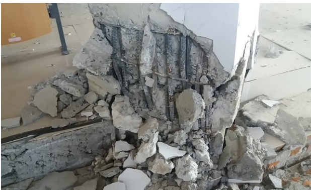
Gambar 8. Kerusakan elemen struktur kolom
